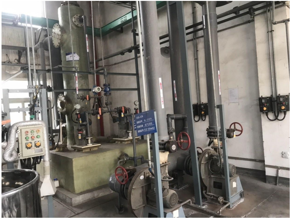
图4-3 项目废气处理设施
