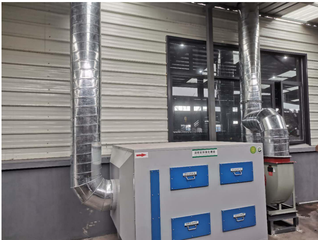
图 3.2-2 挤出废气活性炭吸附装置
