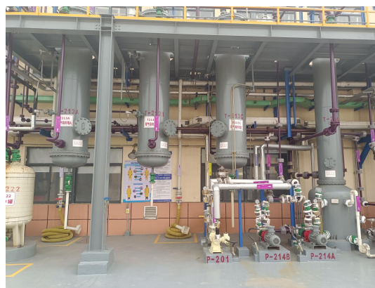
阳极废气预处理设施
